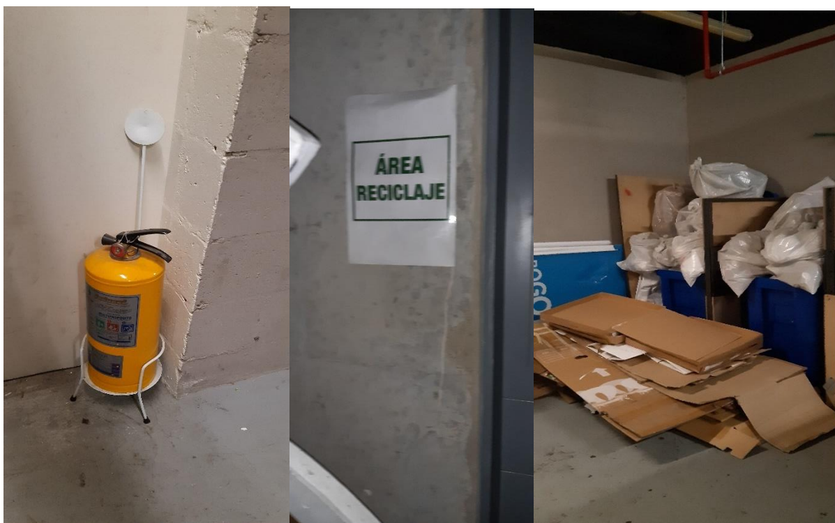
Foto No.3: Cuarto almacenamiento temporal residuos aprovechables SG-SJG (2022)
